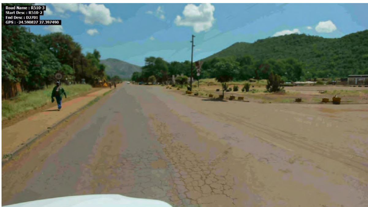
Photo 3.4: Road R510-3 (km 0,1): Surface cracks
